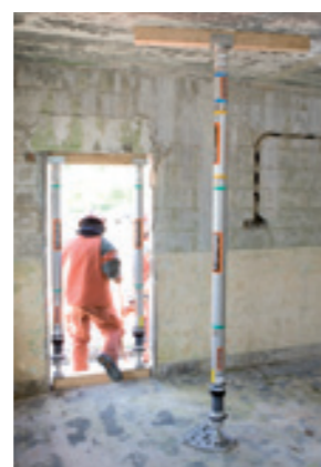
Escora protegendo uma rota de saída.
