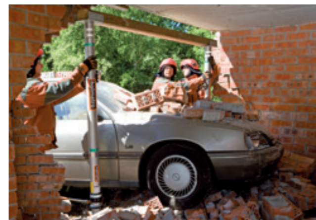
Colocação de dois cilindros com cabeças suporte de viga, estabilizando um edifício. Os cilindros hidráulicos com contra-porca podem-se abrir cuidadosamente com a bomba manual.
