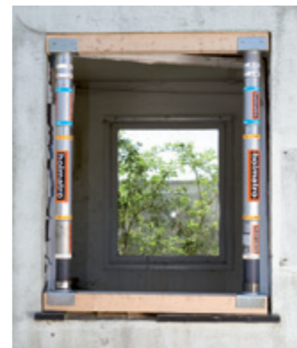
Cilindros manuais com extensões, cabeças suporte de viga e madeira, estabilizando uma janela.
