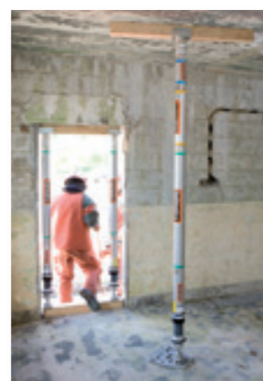
Plafondstut ter bescherming van een uitgangsroute.
