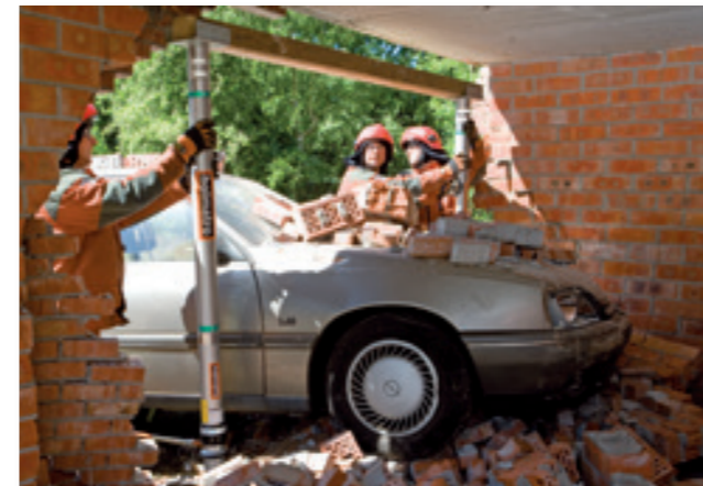
Het plaatsen van twee stutten met balksteunen in een ingestort gebouw. De hydraulische borgmoerstutten worden gecontroleerd verlengd met behulp van een handpomp.
